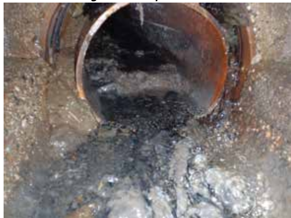
Zjištěné netěsnosti kanalizace budou průběžně opravovány.
