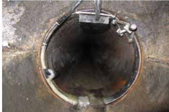
V celkem šesti šachtách byly na potrubí instalovány snímače polohy hladiny a rychlosti proudění.
