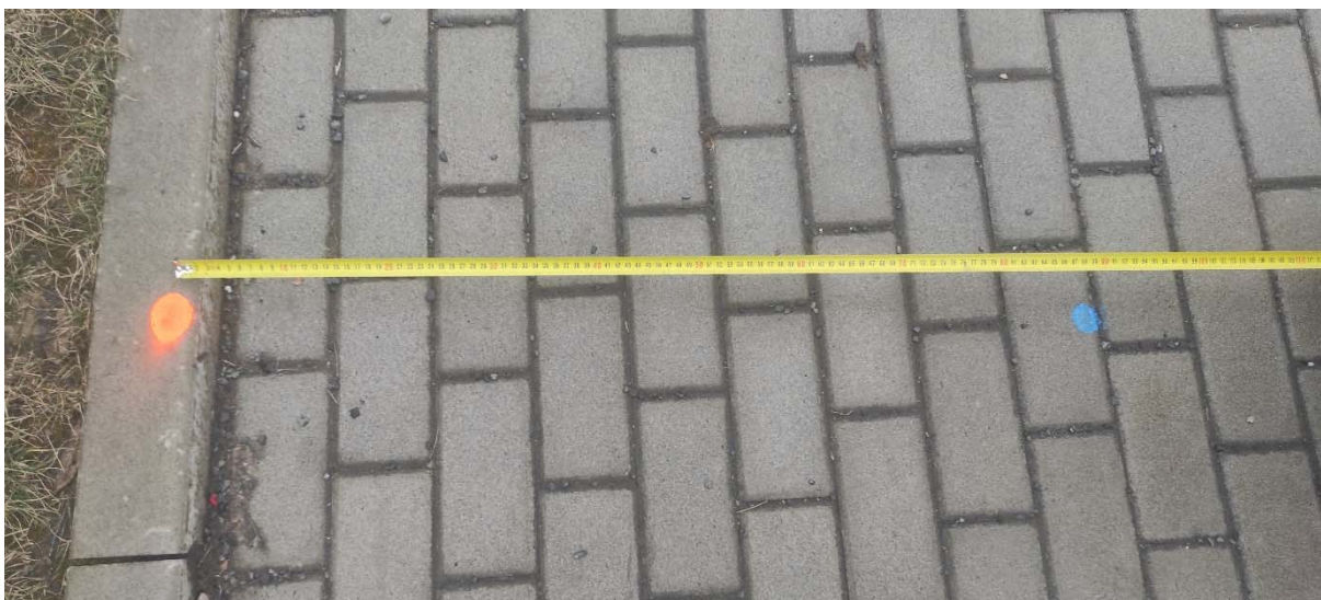
Foto 6: Vodovod vytyčený dle PD skutečného provedení stavby (oranžová barva) a vypískaný pomocí identifikačního vodiče (modrá tečka) v ul. Psárská – vzdálenost mezi vytyčenými body je v tomto místě cca 0,88 m
