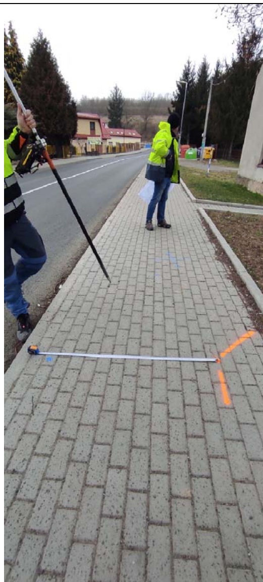
Foto 4: Vodovod vytyčený dle PD skutečného provedení stavby (oranžová barva) a vypískaný pomocí identifikačního vodiče (modrá tečka) v ul. Psárská - vzdálenost mezi vytyčenými body je v tomto místě cca 1,22 m
