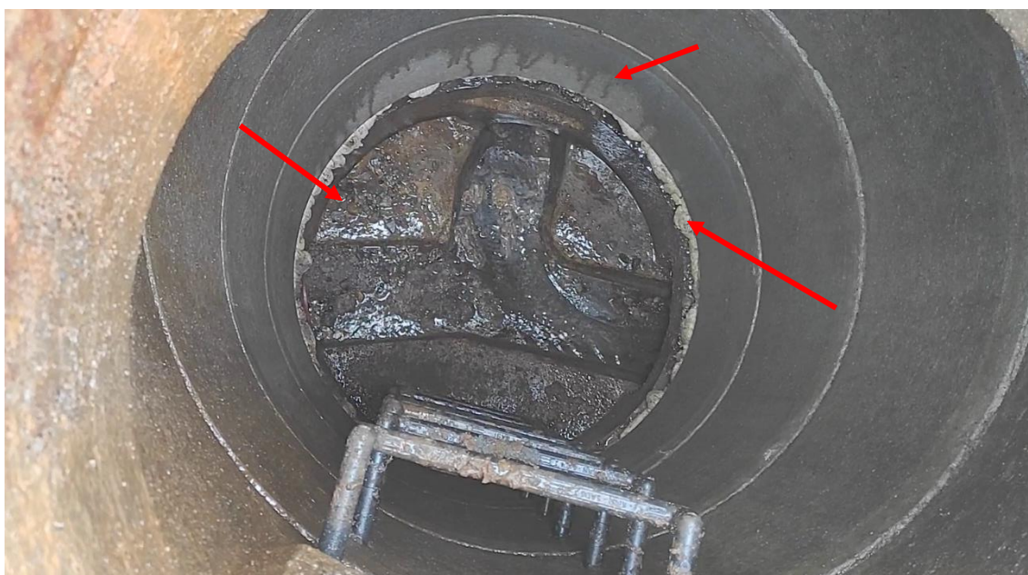
Obr. 15 Fotografie vnitřního prostoru šachty ŠAA (na snímku je patrné použití montážní pěny v přechodu dna a prefabrikovaných skruží a masivní průsaky balastní vody, 8. 3. 2023 [99])
