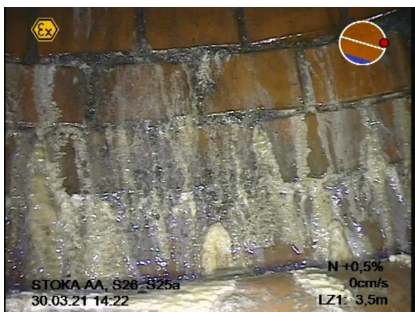
Obr. 42 Detailní pohled na inkrustace a průsaky (zděnými) stěnami dna šachty ŠAA-25a (snímek z 30. 3. 2021 [10.5])
