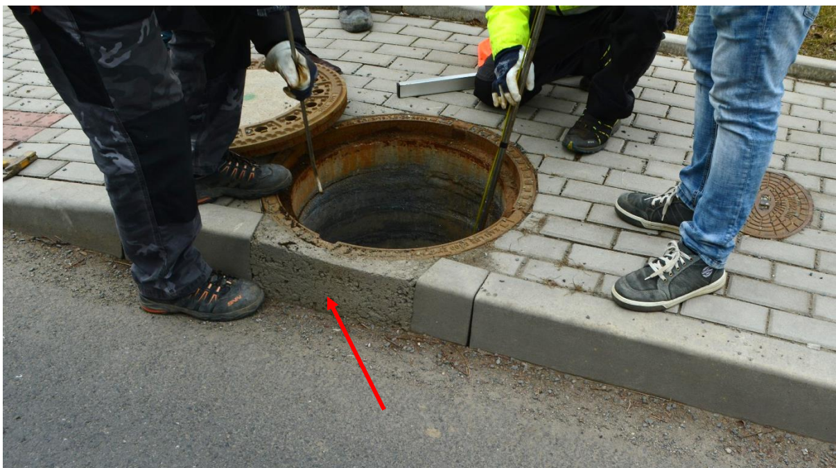
Obr. 11 Nevhodně provedený obrubník ze suchého betonu u poklopu ŠAA-19 (8. 3. 2023 [99])
