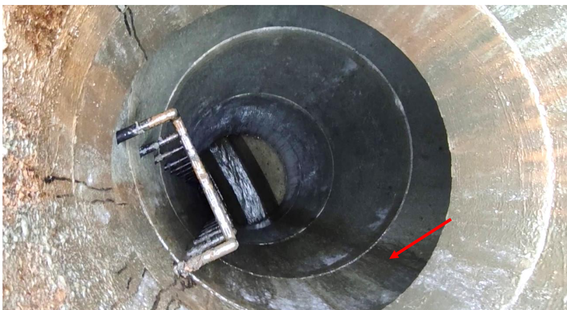
Obr. 13 Fotografie vnitřního prostoru šachty ŠAA-35 (na snímku jsou patrné průsaky spárami mezi skružemi, 8. 3. 2023 [99])
