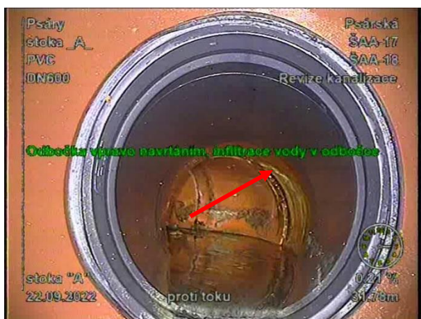
Obr. 46 Nátok balastních vod přípojkou na úseku ŠAA-17/ŠAA-18, přípojka provedena patrně po 08/2021, protože v prvních kam. průzk. není evidována – není vada sběrače (snímek z 22. 9. 2022 [54])
