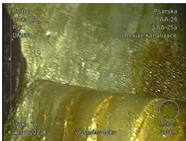
Obr. 43 Sanace zděného dna šachty ŠAA-25a, k infiltraci vody do šachty dochází i přes provedenou opravu (22. 9. 2022 [54])
