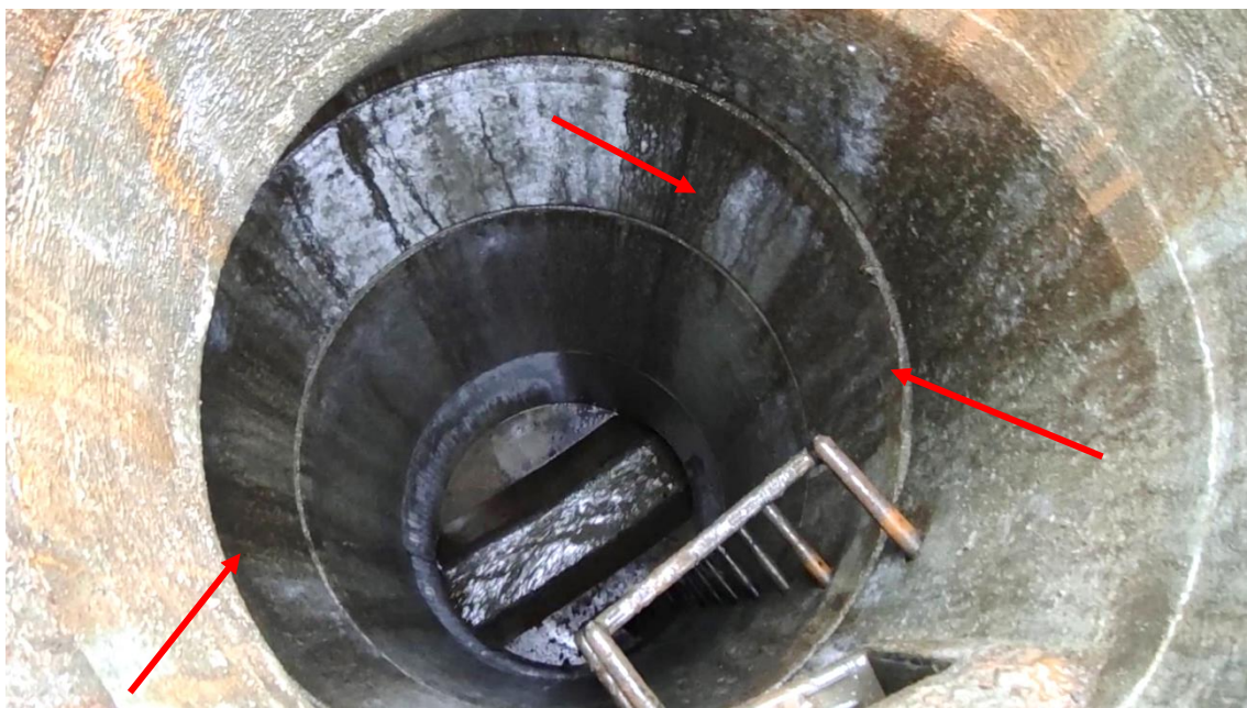
Obr. 12 Fotografie vnitřního prostoru šachty ŠAA-28 (na snímku jsou patrné průsaky spárami mezi skružemi, 8. 3. 2023 [99])
