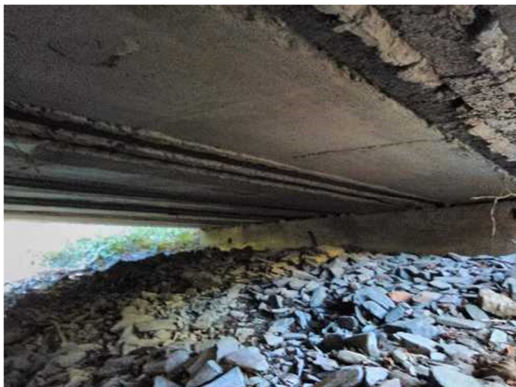
podhled nosné konstrukce, naplaveniny v mostním otvoru, koroze dolních pásnic ocelových nosníků
