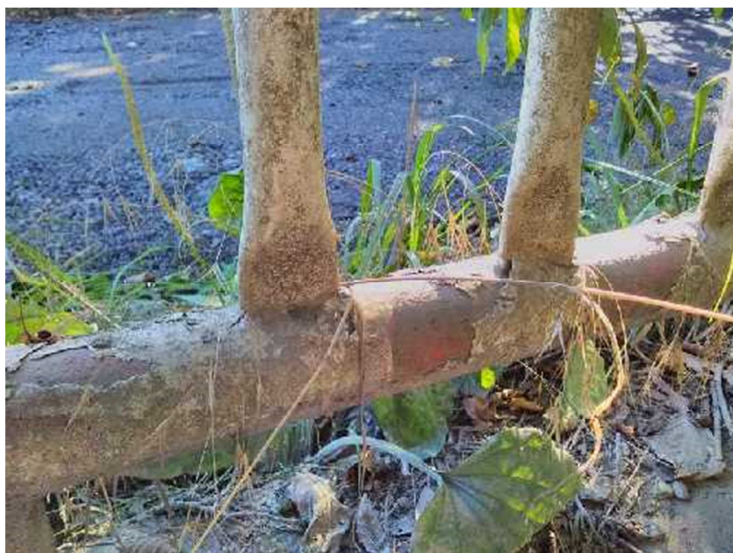
zábradlí - detail koroze
